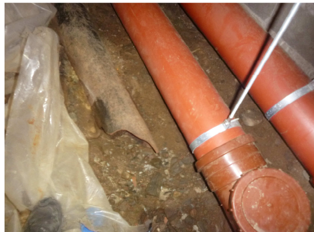
Bild 4. Exempel på äldre avloppsrör som är öppna.
