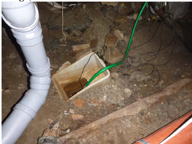
Bild 7. Exempel på dräneringsbrunn.
