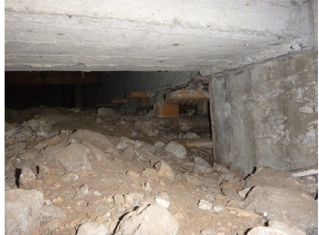
Bild 2. Exempel på kvarlämnade gjutformar.
