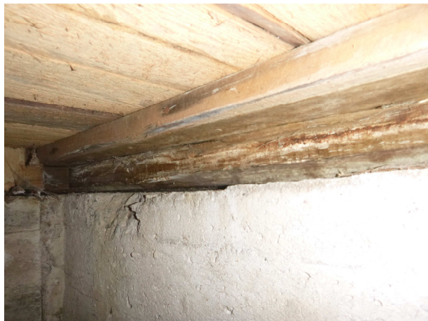
Bild 8. Exempel på spår av periodvis förekommande kondens på grundmur.
