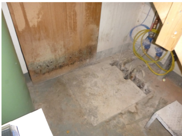
Bild 11. Otät lucka vid dräneringsbrunn i källaren, samt fuktskadad dörr.
